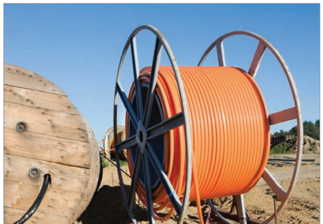
Fiber-optic conduit spools
